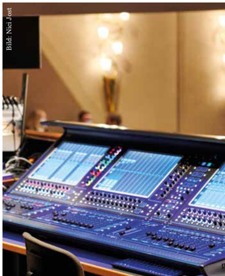
Die Regiekabine wurde neu gebaut und mit einem 96-Kanal-Audiomischpult von Digico und einem ETC-T1-Lichtpult ausgerüstet.
