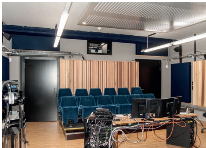
Blick in die Regie: Gut sichtbar sind die Akustikelemente (Absorber, Diffusoren) sowie auch die seitliche Beschallung.
