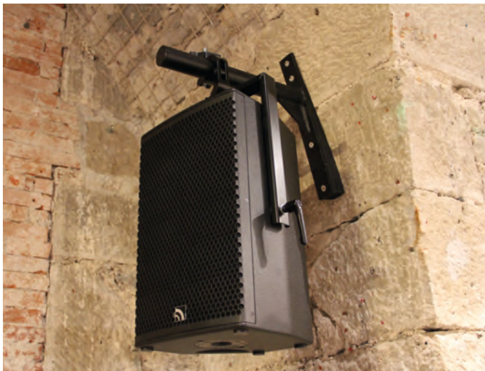
Neu installierte Pro-Audio-Technology-Lautsprecher im Theater Winkelwiese.
