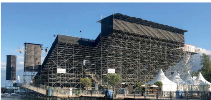
Die Bühne und die Tribüne im See bestanden überwiegend aus Stützen, Streben, Trägern und Platten. Für die Künstler und das Publikum waren die Konstruktionen nur über Stege zu erreichen.
