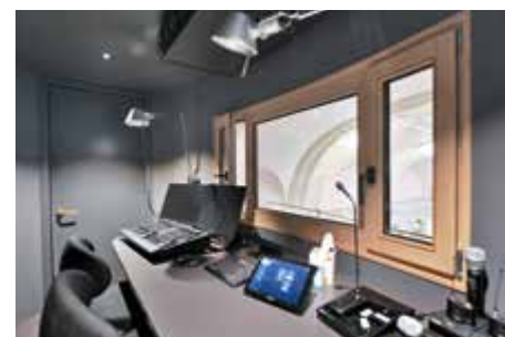
Der neue Regieraum ermöglicht die Kontrolle über die gesamte Saaltechnik.
