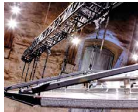
Wandelbar: Die Alu-Riggs und Traversen können je nach Konzertsituation flexibel eingesetzt werden.
