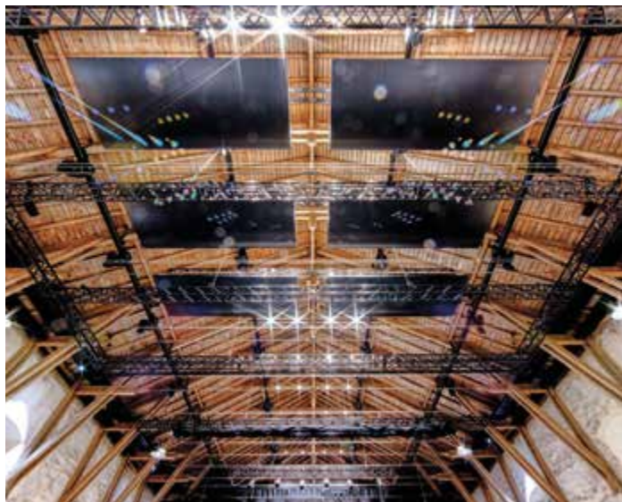
Kraftpaket: Der historische Dachstuhl trägt nach dem Bau eines neuen Dachs die Obermaschinerie an vier 65 m langen Schwerlastschienen.
