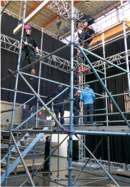
Höhenarbeit: Beste Voraussetzungen für die PSAGa-Ausbildung und den Gerüstbau, hoch über dem Hallenboden.
